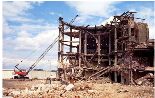
Destruction finale au niveau de la rotonde.
